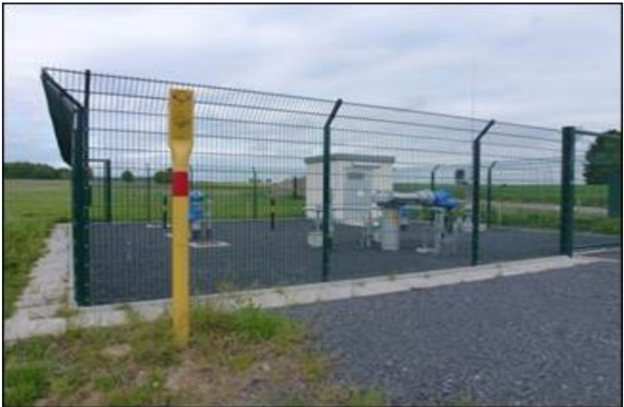
Abbildung 8: Beispielbild einer Armaturenstation
